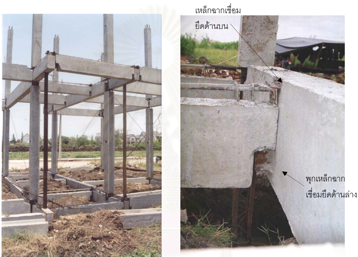
รูปที่ 5-47 แสดงการติดตั้งคานยื่น และการติดตั้งคานชอย
