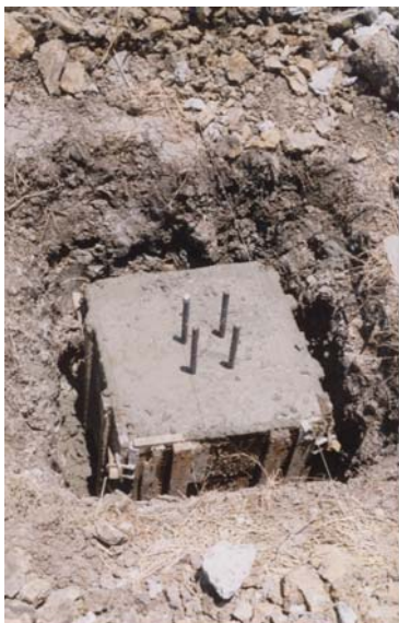
รูปที่ 5-33 .. แสดงการทำไม้แบบหล่อฐานราก
