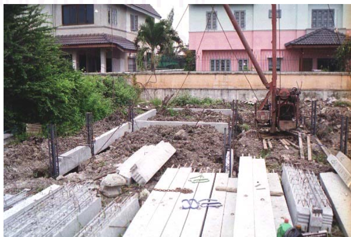
รูปที่ 5-38 . แสดงการเชื่อมยึดเหล็กเสริม และการยกขึ้นส่วนคานคอดินติดตั้ง
