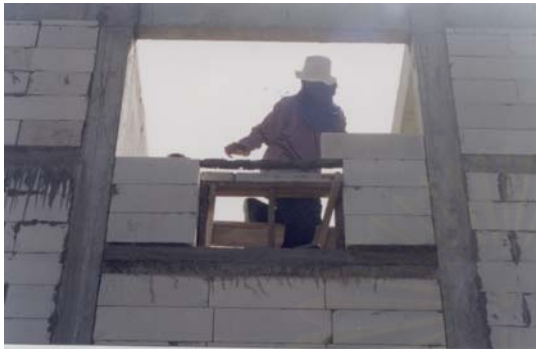
ก. การเสริมเหล็กเส้นแทนการใช้ทับหลังคอนกรีต
