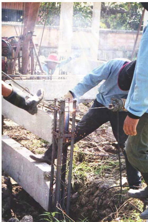
รูปที่ 5-72 แสดงการตัดเหล็กที่เกินจากชิ้นส่วนเสาเหล็กเสริม
