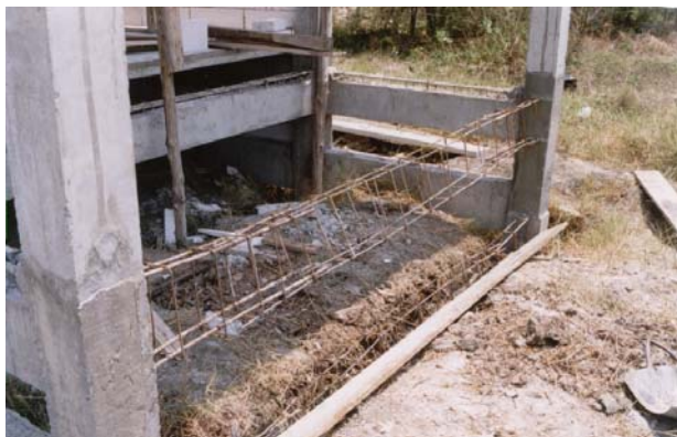
รูปที่ 5-76 แสดงการผูกเหล็กคานและคานคอดินที่ไม่ได้มาตรฐาน
