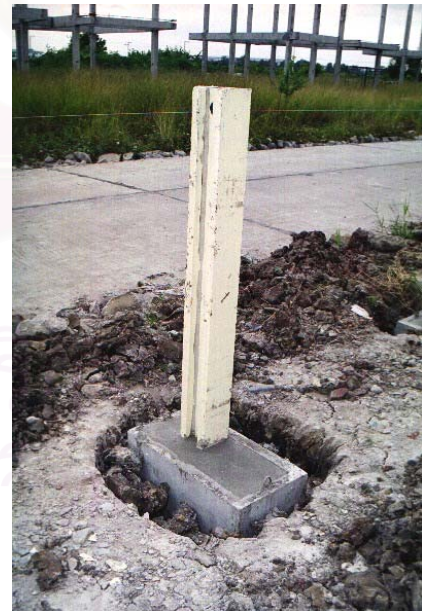
ง. นำเสารั้วสำเร็จมาวางตั้งแล้วเทคอนกรีต ลงไปจนเต็มแบบตอม่อ
