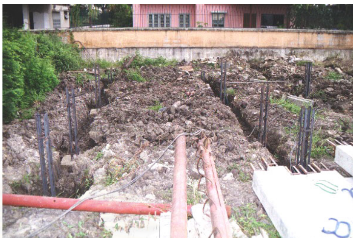
รูปที่ 5-34 . แสดงการขุดร่องดินเพื่อวางคานคอดิน
