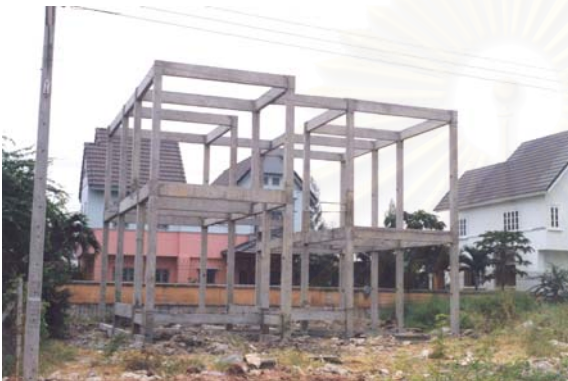
ฉ. แสดงโครงสร้างหลักประกอบติดตั้งเสร็จ ส่งงานโครงสร้างของซีคอน ( 4 วัน )
