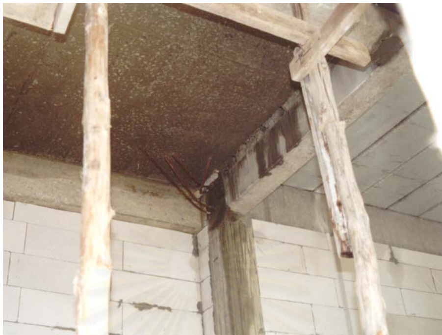
รูปที่ .5-87 แสดงเหล็กเส้นที่เกินออกมาจากชั้นส่วนคานสำเร็จรูป
