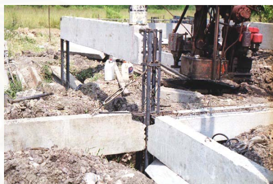
ง. การใช้คาน 3 คานต่อเสา 1 ต้น (ที่ระดับคานคอดิน) โดยใช้เหล็กเสริมแบบงอเป็นฉาก 1 เส้น และแบบตรง 1 เส้น และคานยกระดับ 1 ตัว
