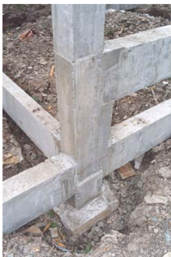
ก. รอยต่อส่วนต่อม่อ-เสา-คาน
