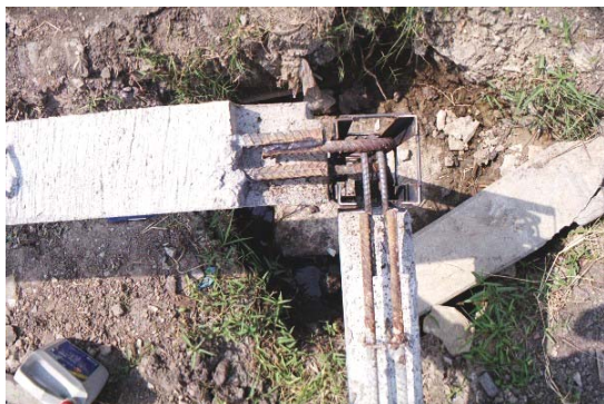
ก. การใช้คาน 2 คานต่อเสา 1 ต้น โดยใช้เหล็กเสริมแบบงอเป็นฉาก 4 เส้น
