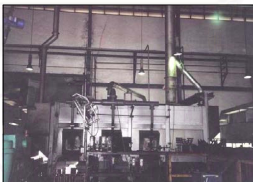
รูปที่ 4.8 เตาเผา ก่อนติดตั้งอุปกรณ์อุ่นอากาศ
