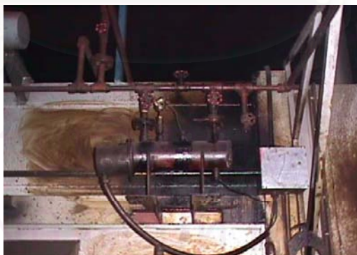
รูปที่ 4.5 Heater ที่ใช้ในการอุ่นน้ำมันเตาก่อนเข้าเผาไหม้
