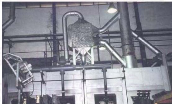
รูปที่ 6.6 เตาเผาหลังติดตั้งอุปกรณ์อุ่นอากาศ
