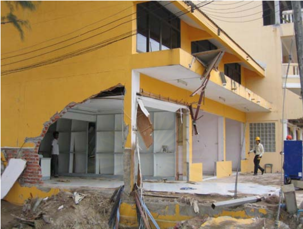
รูปที่ 3.8 ความเสียหายโดยรวมของอาคารระดับเสียหายในชั้นส่วนรอง
