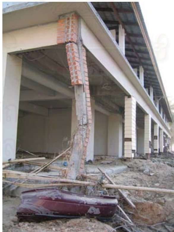
รูปที่ 3.6 ความเสียหายที่เกิดขึ้นในเสาระดับที่ 5
