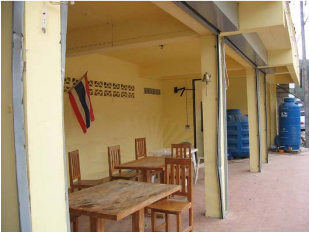
รูปที่ 3.1 ความเสียหายที่เกิดขึ้นในเสาระดับที่ 0
