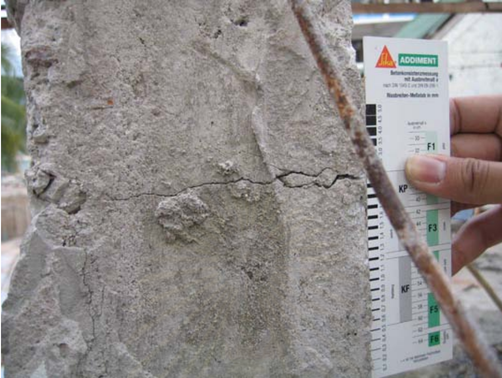
รูปที่ 3.5 ความเสียหายที่เกิดขึ้นในเสาระดับที่ 4
