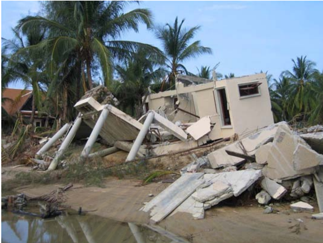
รูปที่ 3.10 ความเสียหายโดยรวมของอาคารระดับโครงสร้างวิบัติ
