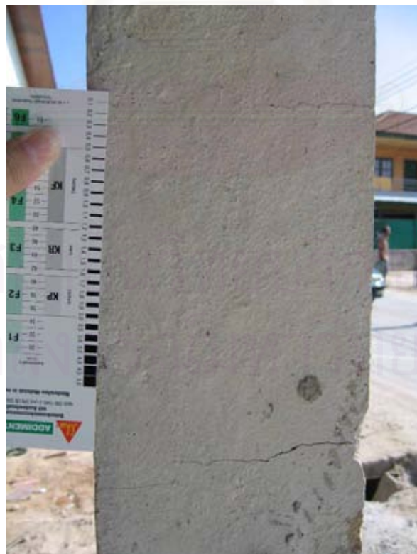
รูปที่ 3.2 ความเสียหายที่เกิดขึ้นในเสาระดับที่ 1
