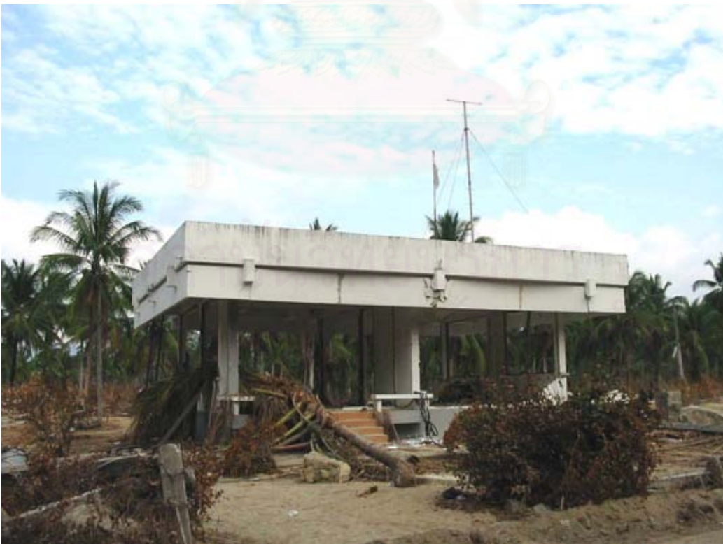
รูปที่ 3.9 ความเสียหายโดยรวมของอาคารระดับเสียหายในชั้นส่วนหลัก
