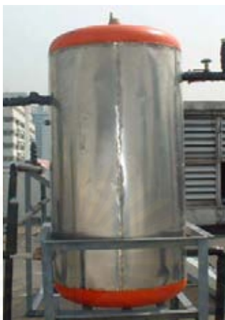
รูปที่ 4.7 ถังเก็บน้ำร้อน
