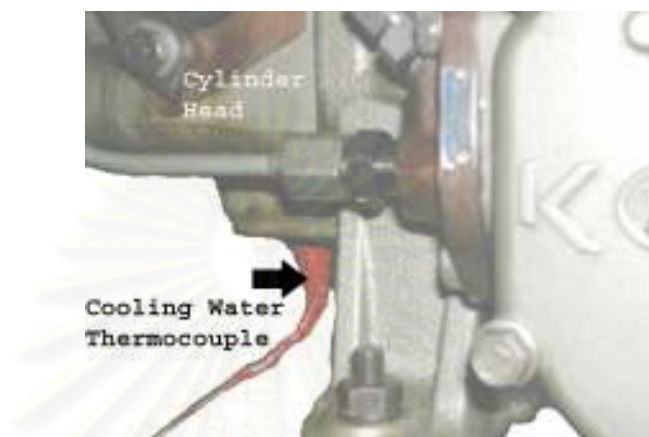
รูปที่ 4-13 ตำแหน่งการติดตั้งเทอร์โมคัปเปิลวัดอุณหภูมิ น้ำหล่อเย็น
