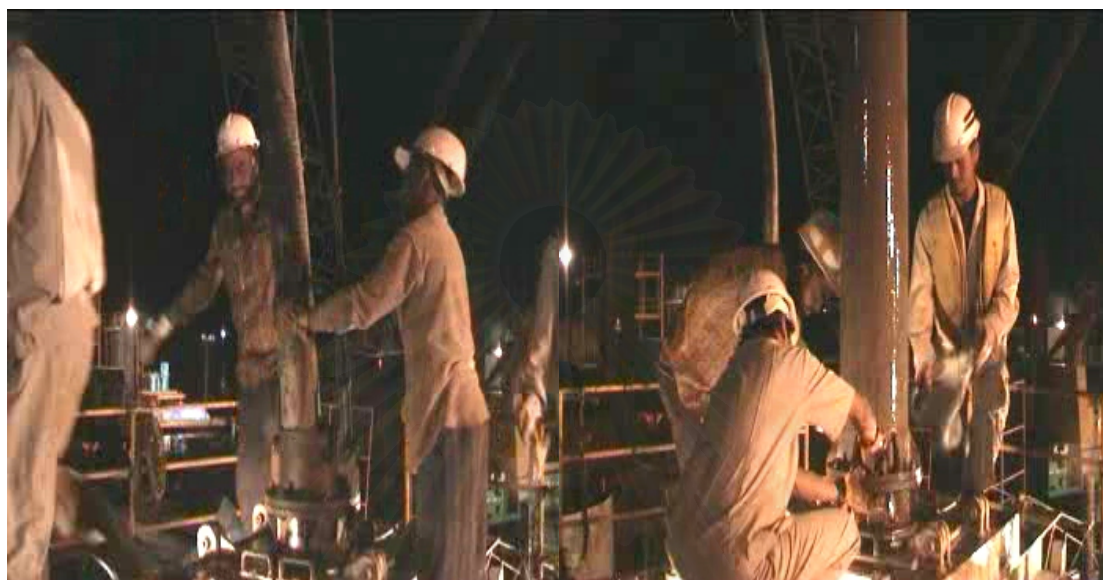
รูปที่ 3.9 แสดงการเทคอนกรีตและการถอดท่อ Tremie
