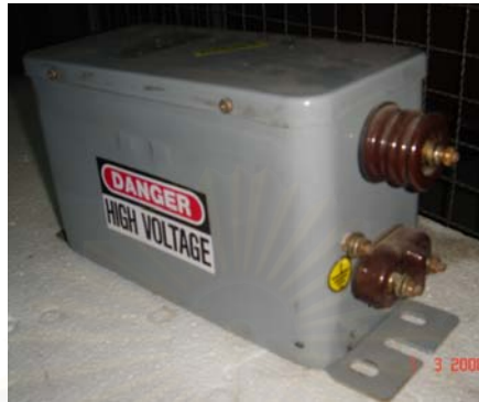
รูปที่ 3.20 : หม้อแปลงไฟฟ้า
