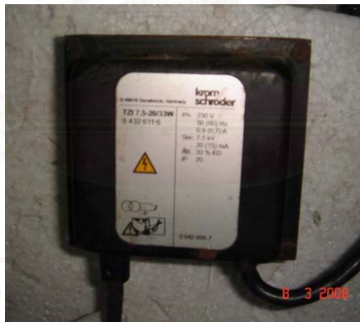
รูปที่ 3.21 : หม้อแปลงสปาร์ก
