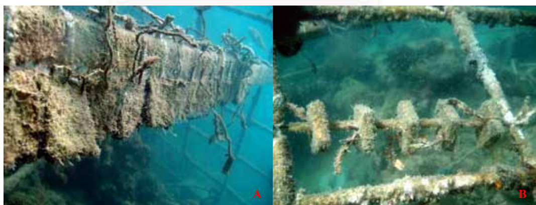
รูปที่ 3.24 การยึดติดแผ่นเหล็กเคลือบหินปูน (A) และแผ่นกระเบื้อง (B) กับโครงสร้างเหล็ก
