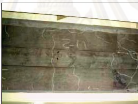
รูปที่ 2.11 ความเสียหายด้านใต้ของแผ่นพื้นสะพานคอนกรีตเสริมเหล็ก
