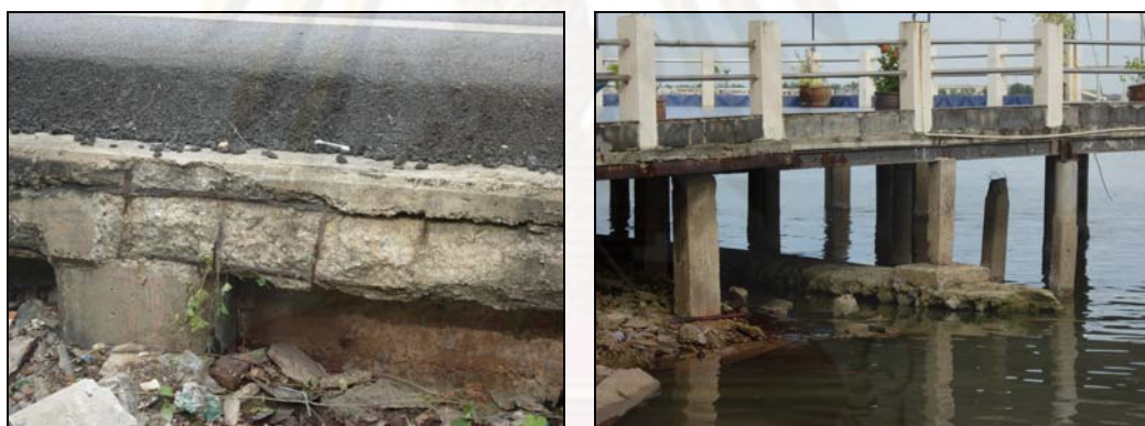
รูปที่ 2.18 การถูกกัดกร่อนของเหล็กเสริมในคอนกรีตจากคลอไรด์
