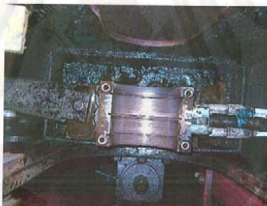
รูปที่ 4.6 คราบน้ำมันสกปรกบริเวณชุดสะพานไฟและบ่าทองเหลืองที่เครื่องชุบทองแดง
