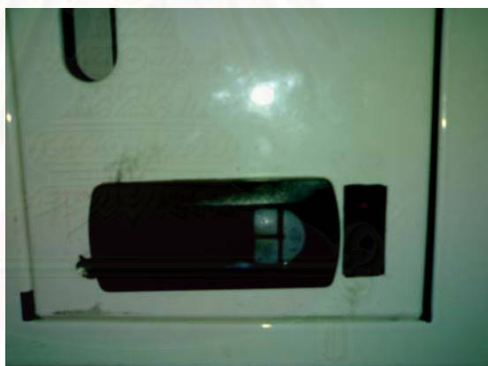
รูปที่ 7.2 จอแสดงอุณหภูมิที่ใช้สั่งการตัดต่ออุณหภูมิใน INNER BOX แบบดิจิทัล
