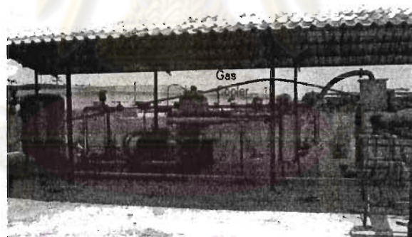
รูป 4.21 อุปกรณ์ระบบดูดและกำจัดก๊าซขยะ
