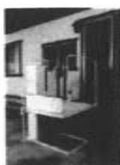
มีสิ่งกีดขวางในอาคาร สำหรับผู้เข็นรถเข็นวีลแชร์
