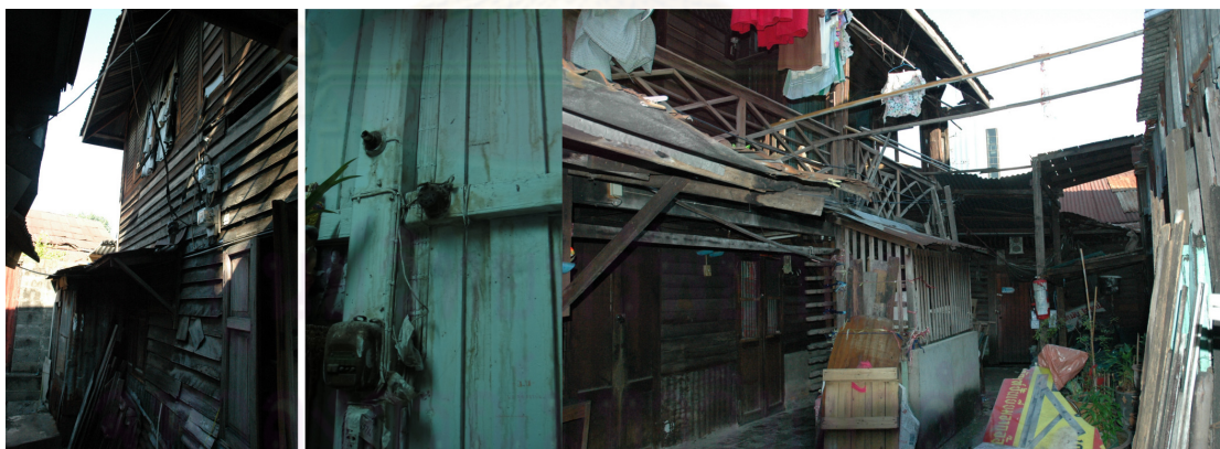
รูปที่ 5.2 แสดงการเดินสายไฟฟ้าที่มีได้มาตรฐาน และบ้านพักอาศัยที่สร้างจากไม้ที่มีลักษณะชิดกัน ทำให้เสี่ยงต่อการเกิดอัคคีภัย
