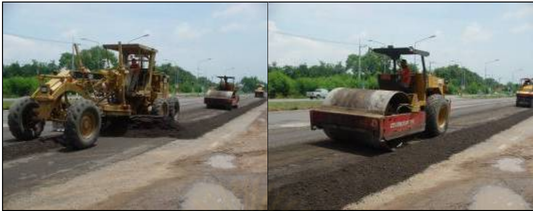
ภาพที่ 4.23 การบดอัดด้วยรถบดล้อเหล็กสันสะเทือน น้ำหนัก 18 ตัน
