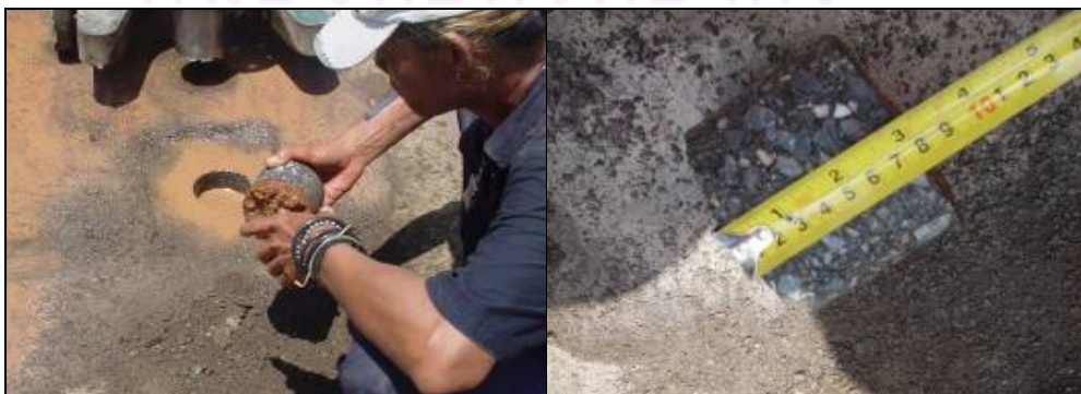
ภาพที่ 4.2 การเจาะสำรวจความหนาของผิวทางแอสฟัลต์คอนกรีตเดิม
