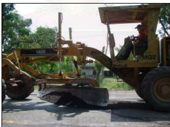
ภาพที่ 4.15 การเพิ่มหินฝุ่นหนา 6 ซม. ลงบนโครงสร้างทางเดิม
