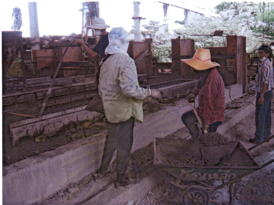
ภาพที่ 8-17 การเทโฟมซีเมนต์ลงในแบบแผ่นพื้น (1)
