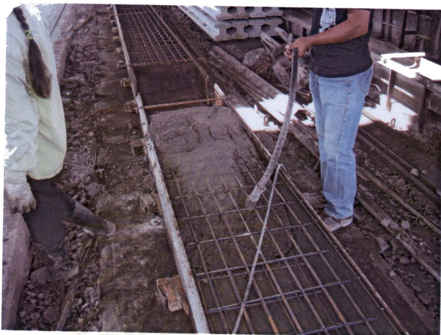
ภาพที่ 8-19 การเทโฟมคอนกรีตลงในแบบแผ่นพื้น (3)
