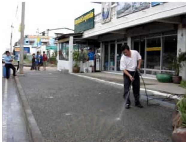
รูปที่ 4.17 การใช้เครื่องฉีดอัดน้ำแรงดันสูง เพื่อทำความสะอาดคอนกรีตพูน
