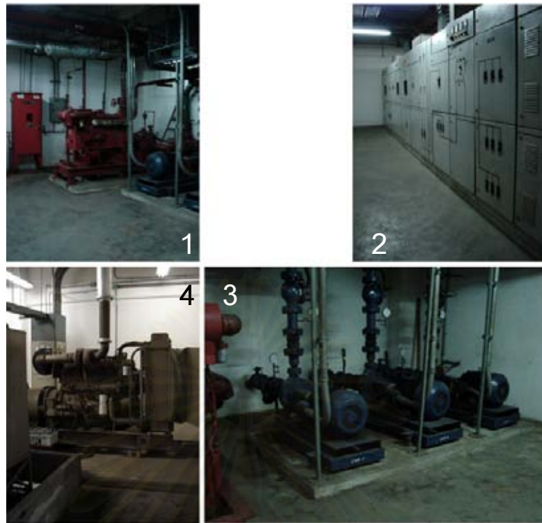
รูปที่ 4.13 แสดงห้องเครื่องไฟฟ้า, ห้องปั้มน้ำ และห้องกำเนิดไฟฟ้าสำรองบริเวณชั้นใต้ดิน
