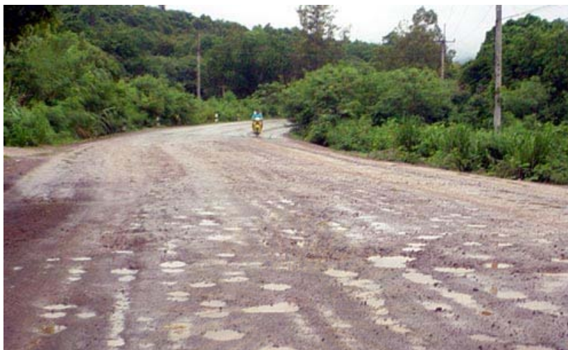
ภาพที่ 2.8 การหลุดร่อนแบบหลุมบนพื้นถนน
