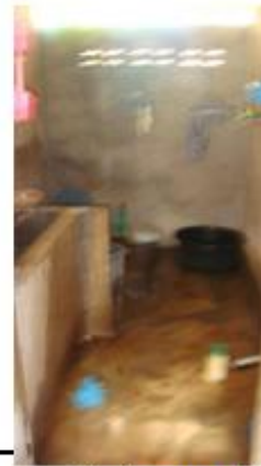
ห้องน้ำแคบมากไม่ สามารถใช้รถเข็นเข้า ห้องน้ำได้
