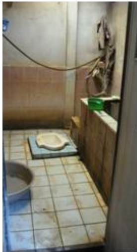
ห้องน้ำปูนกระเบื้องชนิดดิน และยังมีระดับแตกต่างกันกับระดับพื้นปกติ
