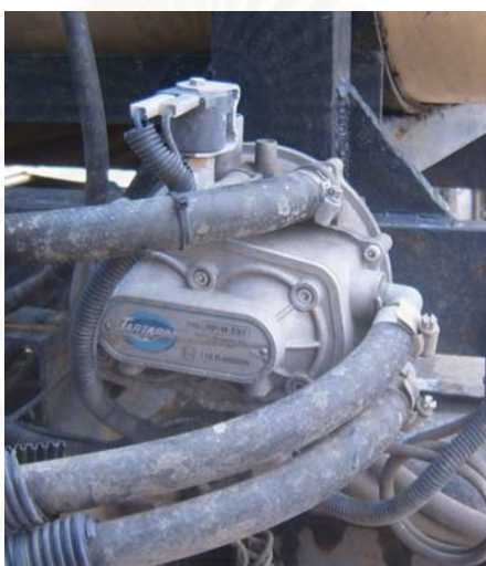
รูปที่ 4-38 แสดงภาพอุปกรณ์ปรับลดความดันก๊าซธรรมชาติที่ติดตั้งในรถหัวลาก Hino รุ่น ZM500
