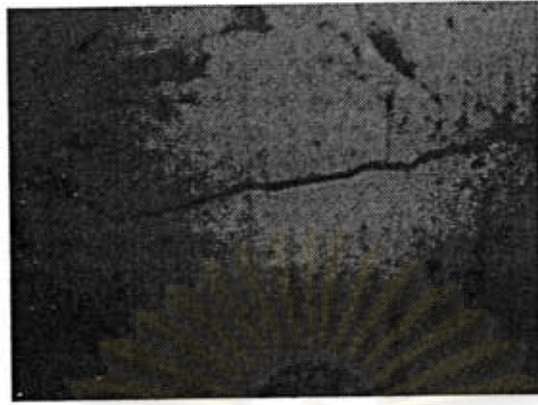
รูปที่ 3.12 รอยแตกของคอนกรีตในอาคารขนาดปานกลาง(ลักษณะเป็นร่องสม่ำเสมอ)
