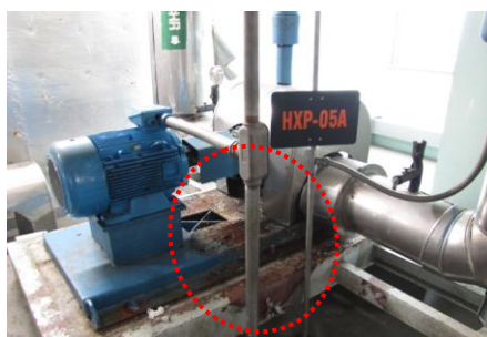
ภาพที่ 3.47 Foundation Corrosion
