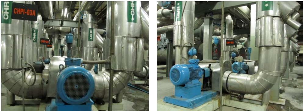
ภาพที่ 3.6 Chilled Water Pump - CHP1
