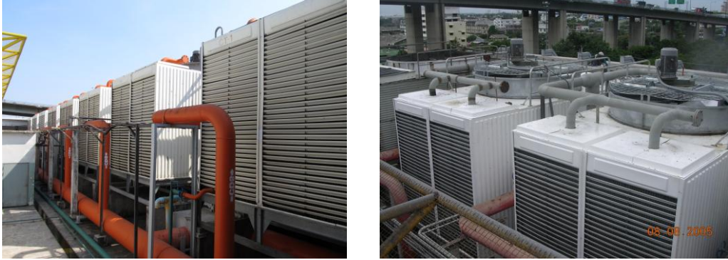
ภาพที่ 3.11 Cooling Tower - CT
