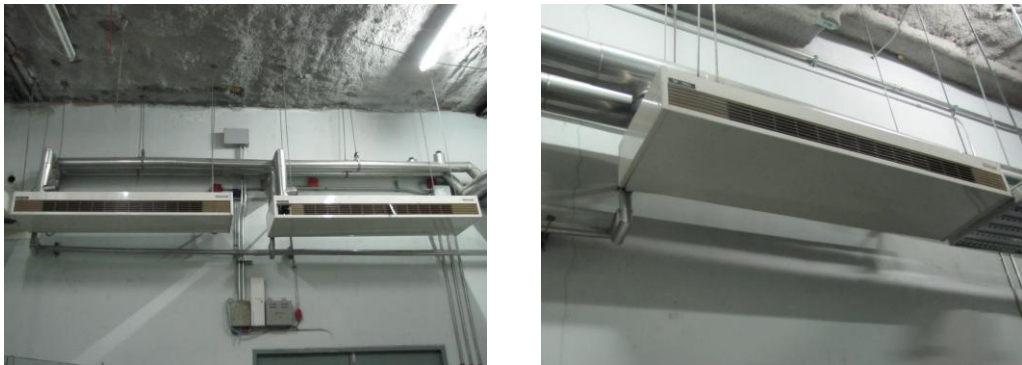
ภาพที่ 3.16 การทำงาน Fan Coil Unit
