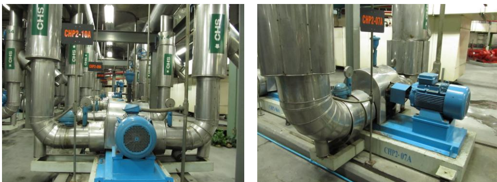
ภาพที่ 3.7 Chilled Water Pump – CHP2
