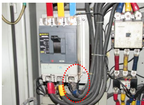
ภาพที่ 3.40 Main Breaker Short Circuit
