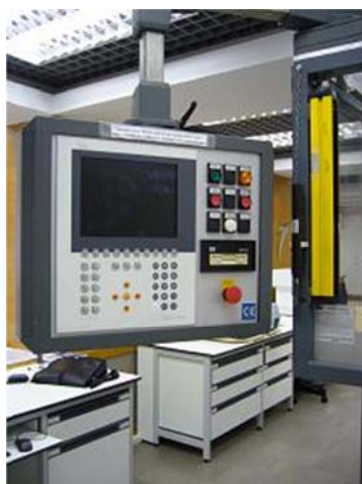
ภาพที่ 3.8 แผงควบคุมเครื่องจักร
