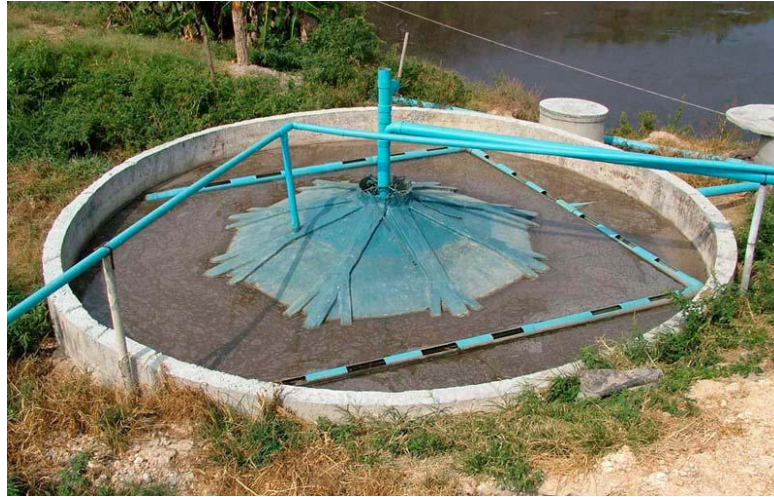
ภาพผนวกที่ ง-6: ตัวอย่างภาพประกอบบ่อยูเอเอสบี (UASB: Upflow Anaerobic Sludge Blanket)
