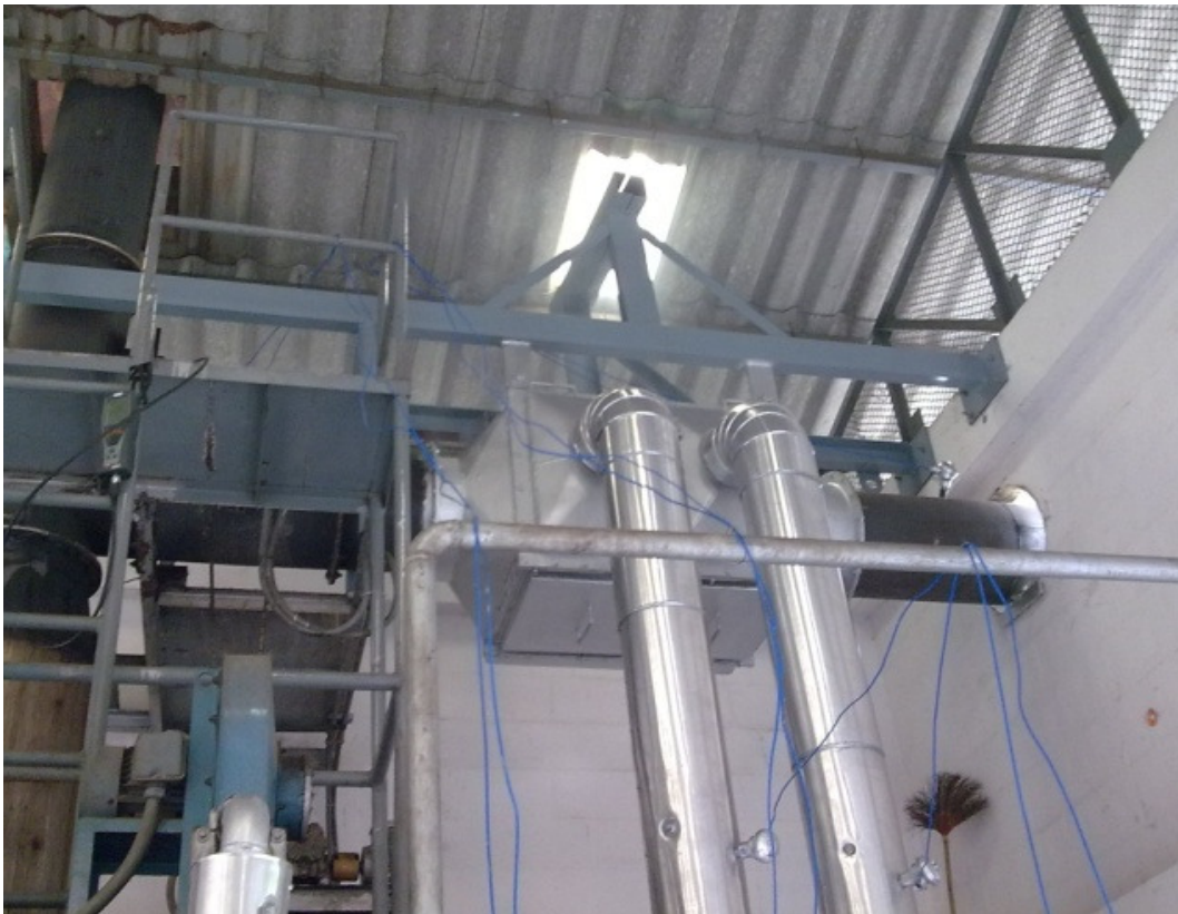
ภาพที่ 4.9 เครื่องอุ่นอากาศที่ติดตั้งเรียบร้อยแล้วพร้อมใช้งาน
