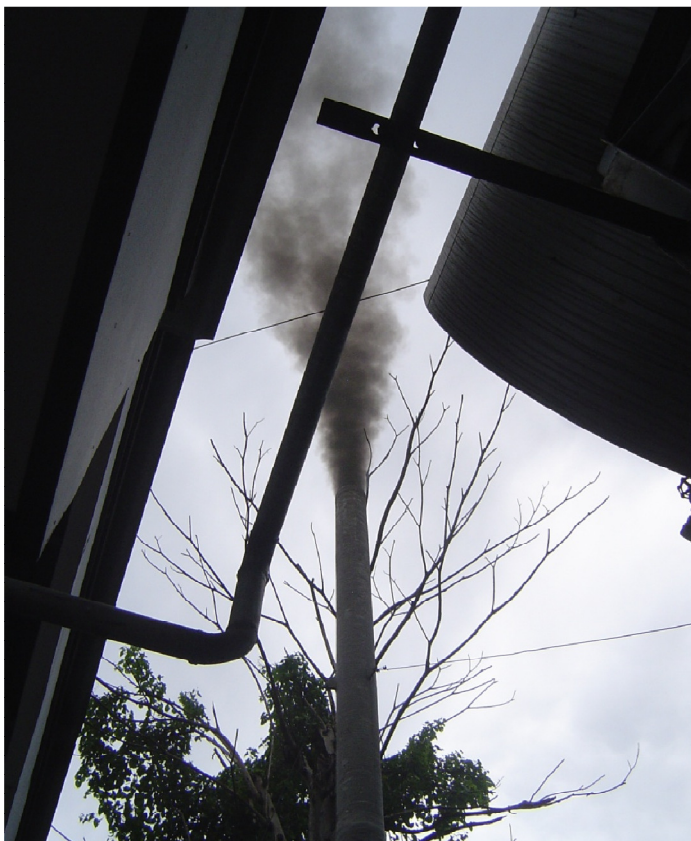
ภาพที่ 6.6 รูปถ่ายแสดงสภาพไอเสียที่ปล่อยทิ้งทางปล่องระบายในขณะที่ป้อนมูลฝอยก่อนการติดตั้งอุปกรณ์อุ่นอากาศ(วันที่ 10 ก.ย. 53)
