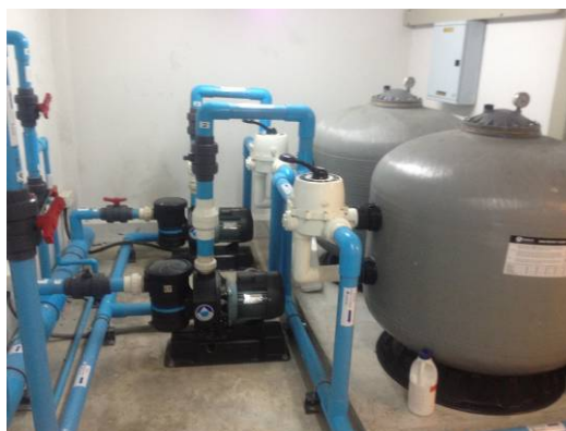
ภาพที่ 3. 1 ภาพตัวอย่างปัญหาระบบสระว่ายน้ำ
