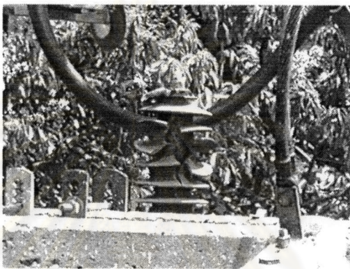
รูปที่ 6.5 กัปกัดฟ้าผ่าเฟส Y บนเสาไฟแรงสูงของผู้ใช้ไฟภายหลังเกิดการระเบิดขึ้น
