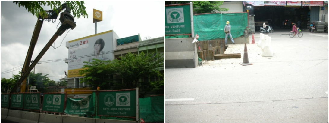
ภาพที่ 5.17 เศษหินและเศษดินกระเด็นออกมานอกเขตพื้นที่ก่อสร้างจากการดำเนินงานก่อสร้าง
