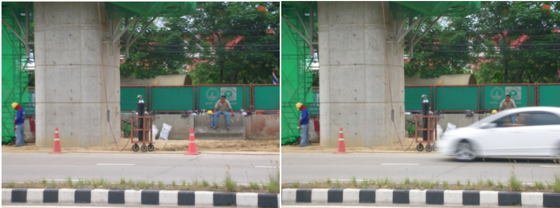
ภาพที่ 5.6 การวางวัสดุก่อสร้างหรือวัตถุอื่นๆ ที่อาจก่อให้เกิดอันตรายบริเวณพื้นที่จราจร
