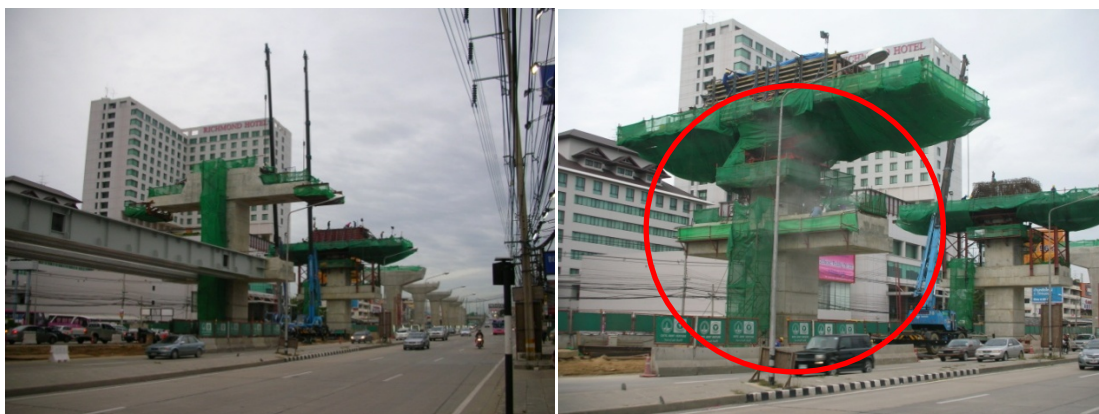
ภาพที่ 5.19 เศษฝุ่นร่วงหล่นระหว่างการดำเนินงานก่อสร้างโครงสร้างส่วนบน
