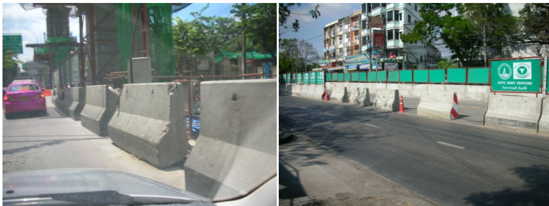
ภาพที่ 5.5 การวางแนวคอนกรีตกั้นระหว่างเขตพื้นที่ก่อสร้างกับถนนบางช่วงไม่ต่อเนื่องและมีการเว้นระยะช่องว่าง
