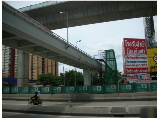
ภาพที่ 5.20 ไม่มีการป้องกันวัสดุที่อาจร่วงหล่นใส่คนเดินเท้าระหว่างการสัญจรผ่านสะพานลอย
