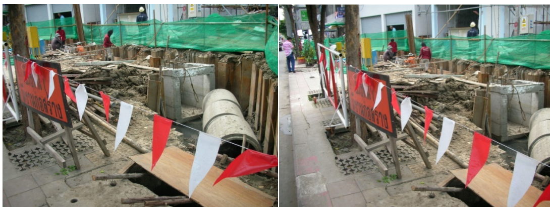
ภาพที่ 5.22 แนวรั้วกันเขตพื้นที่ก่อสร้างกับพื้นที่ทางเดินเท้ามีสภาพไม่แข็งแรงและครอบคลุมเพียงพอต่อการป้องกันอุบัติเหตุ
