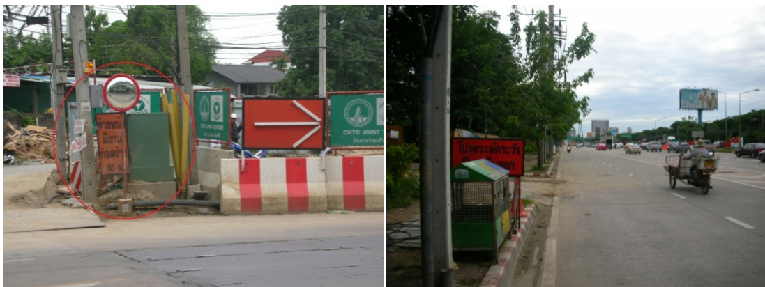
ภาพที่ 5.33 การติดตั้งป้ายแจ้งเตือนในตำแหน่งที่สังเกตได้ยาก
