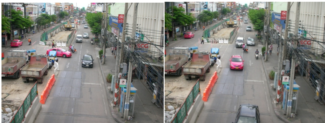
ภาพที่ 5.13 แนวรั้วกำแพงคอนกรีตกับผ้าใบบดบังทัศนวิสัยของผู้ขับขี่ในการมองเห็นบริเวณจุดกลับรถ
