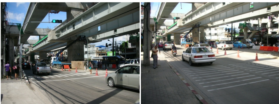
ภาพที่ 5.10 ไม่มีการกั้นระหว่างเขตพื้นที่ก่อสร้างกับพื้นที่ทางม้าลายที่ผ่านเขตพื้นที่ก่อสร้าง
