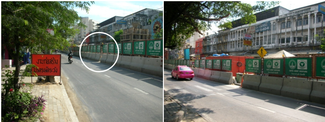
ภาพที่ 5.14 แนวรั้วกำแพงคอนกรีตกับผ้าใบบดบังทัศนวิสัยของผู้ขับขี่ในการมองเห็น บริเวณทางข้าม
