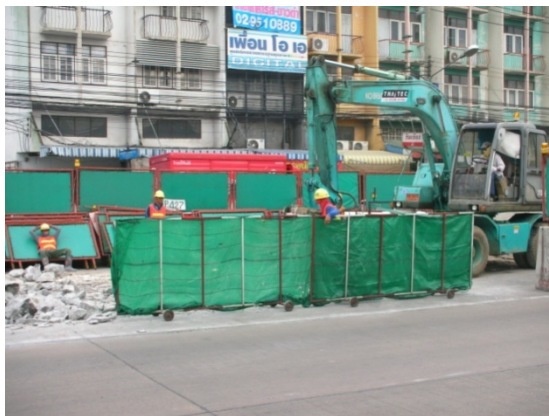
ภาพที่ 5.16 การเจาะพื้นผิวถนนโดยมีการวางรั้วเหล็กที่คลุมด้วยผ้าใบกันน้ำในบริเวณที่มีการเปิดเขตพื้นที่ก่อสร้างเพื่อป้องกันการกระเด็นของเศษปูน
