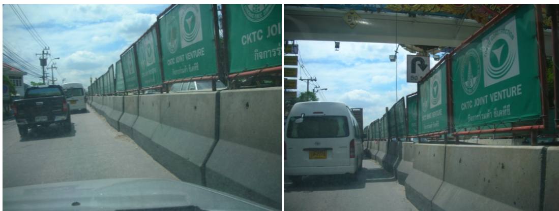
ภาพที่ 5.4 การวางแนวคอนกรีตกันระหว่างเขตพื้นที่ก่อสร้างกับถนนบางช่วงมีลักษณะบิดเบี้ยว
