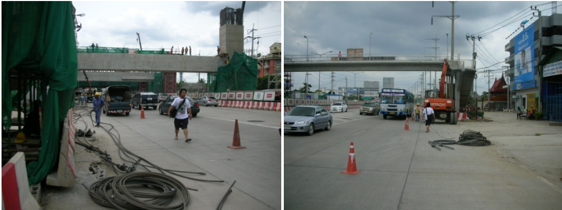
ภาพที่ 5.9 ไม่มีการแยกพื้นที่ที่อยู่ระหว่างการดำเนินงานก่อสร้างกับทางเดินเท้า
