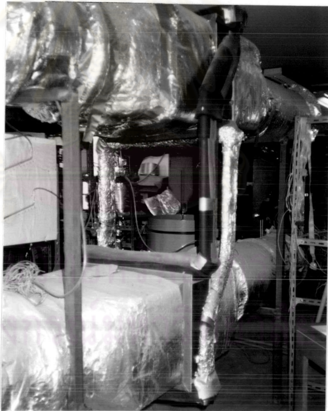
รูปที่ 4.10 เครื่องแลกเปลี่ยนความร้อนแบบคอยล์ ลูป เทอร์โมไฮฟอน หลังต่อท่อไอระเหยและท่อของเหลวควบแน่นไหลกลับ
