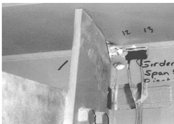
ภาพที่ 2.1 ตำแหน่งที่ติดตั้งเกจวัดความเครียดในบริเวณ web gap ที่ใกล้กับปีกด้านบน
