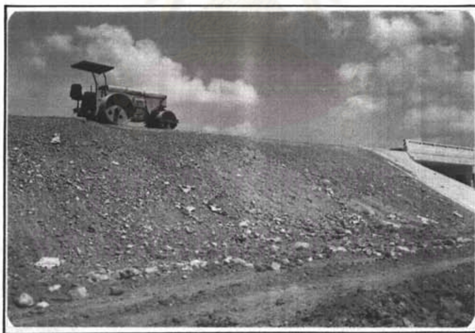
ภาพประกอบที่ 5 แสดงระดับความสูงของถนน By-Pass บริเวณสะพานระบายน้ำ
