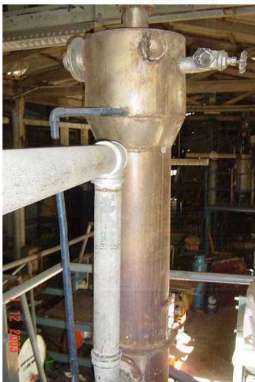
รูปที่ 3.8 หอดูดซึม (Absorption column)
