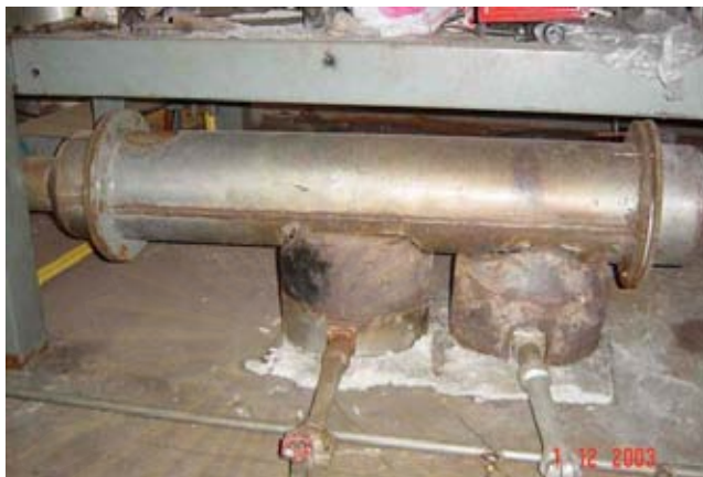
รูปที่ 3.6 ระบบอุ่นอากาศ (air preheater)
