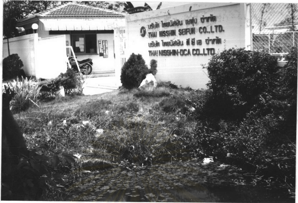
ภาพที่ 7. แสดงตำรากระบายน้ำฝนหน้าโรงงานไทยนิสชิน เซฟุน จำกัด
