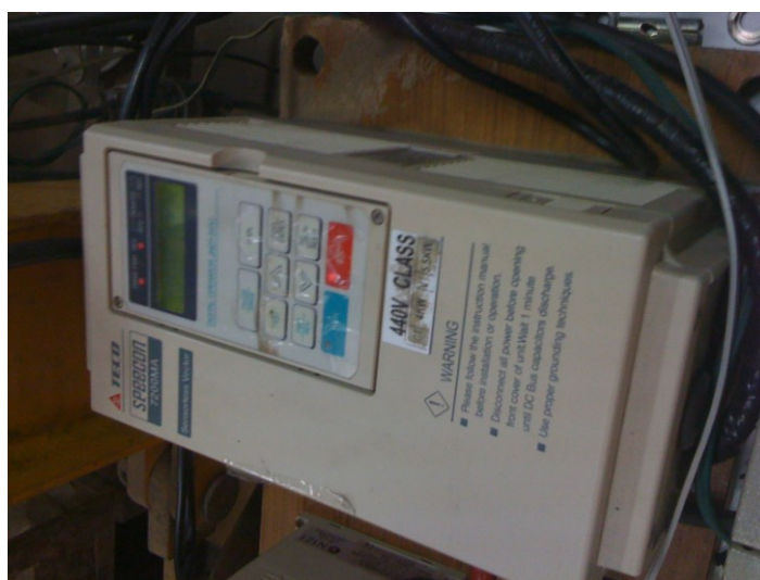
ภาพที่ ง.2 Inverter ควบคุมมอเตอร์ไฟฟ้าตัวขับเคลื่อนทดลอง
