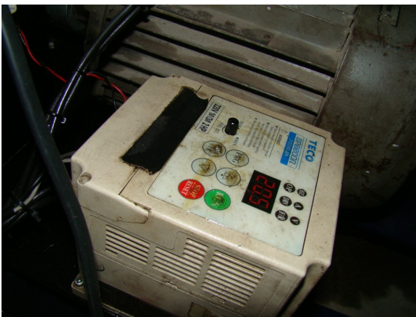
ภาพที่ ค.4 ระบบน้ำมันหล่อลื่นควบคุมอัตราการไหลโดยการปรับความเร็วรอบจากอินเวอร์เตอร์ของมอเตอร์ตัวขับปั้มน้ำมัน
