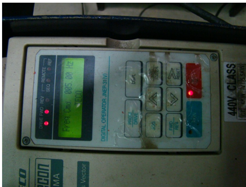
ภาพที่ ค.15 ปรับเปลี่ยนความเร็วรอบโดยอินเวอร์เตอร์ที่ใช้ควบคุมความถี่ของมอเตอร์ตัวขับ
