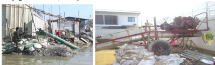
ภาพที่ 5.19 แสดงการเตรียมเครื่องสูบน้ำแบบเคลื่อนที่ได้ (Mobile Pump) เพื่อใช้กรณีสูบน้ำออกจากพื้นที่โครงการขณะเกิดน้ำท่วม
