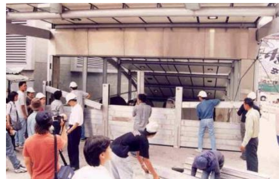
ภาพที่ 2.15 แสดงการติดตั้งแผ่นกั้นน้ำแบบถอดได้ (Stop Log) ที่ลงทางสถานีรถไฟ
