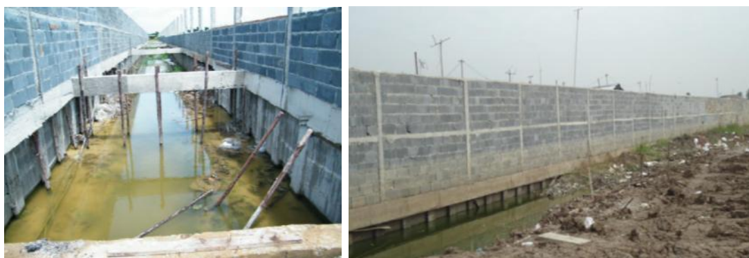
ภาพที่ 4.29 แสดงรั้วเชื่อมโครงการ แบบผนังรั้วเป็นก่ออิฐฉาบปูน
