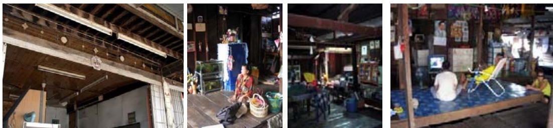
รูปที่ 6.44 แสดงสิ่งอำนวยความสะดวก เครื่องใช้ไฟฟ้า ทำให้เสี่ยงต่อการเกิดอัคคีภัย
