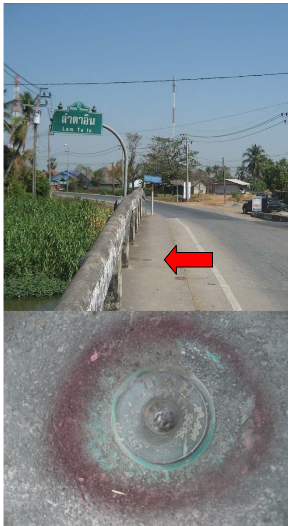
รูปที่ 10 แสดงลักษณะหมุดระดับที่นำมาใช้เป็นหมุดตรวจสอบ
