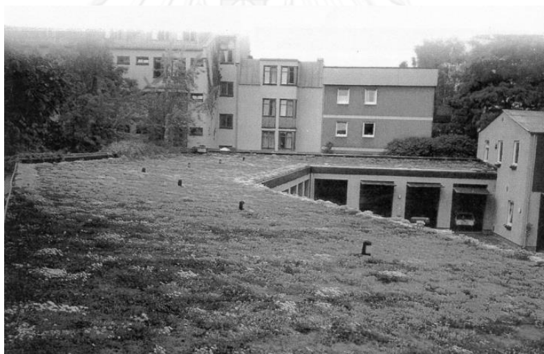
รูปที่ 8 หลังคาแบบ Extensive green roof บริเวณหลังคาลานจอดรถในประเทศเยอรมัน ที่มา : http://greeningthecity.files.wordpress.com/2008/07/01-xeroflojapan1.jpg
