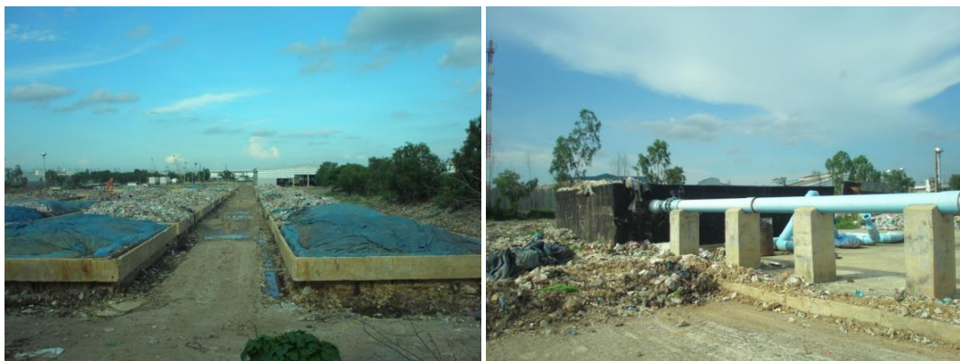
รูปที่ 4.10 บ่อหมักขยะ และรูปท่อส่งก๊าซ บริเวณด้านนอกอาคาร
