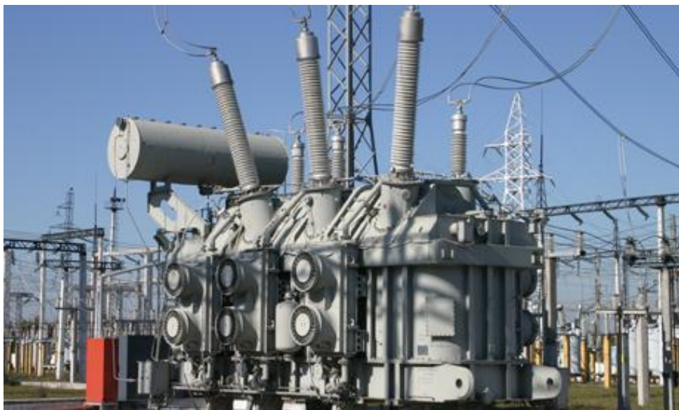
รูปที่ 3. 40 Transformer
