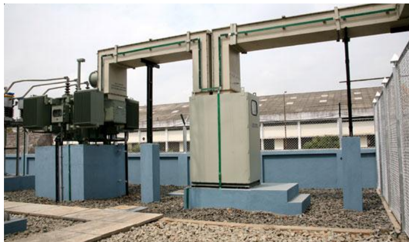
รูปที่ 3. 13 Bus Duct
