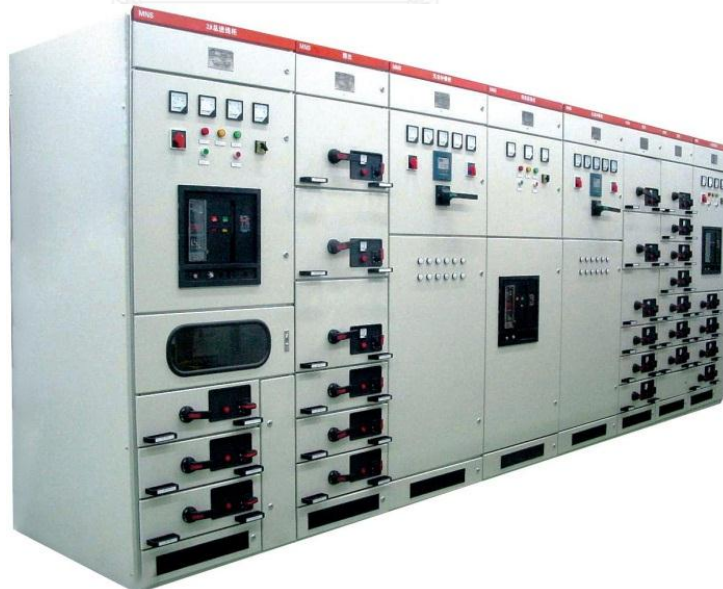
รูปที่ 3. 34 Switchgear
