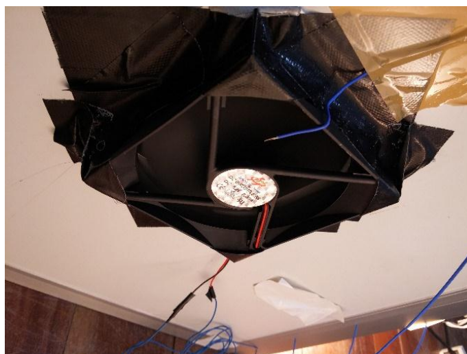
รูปที่ 15 อุปกรณ์ระบายอากาศ
