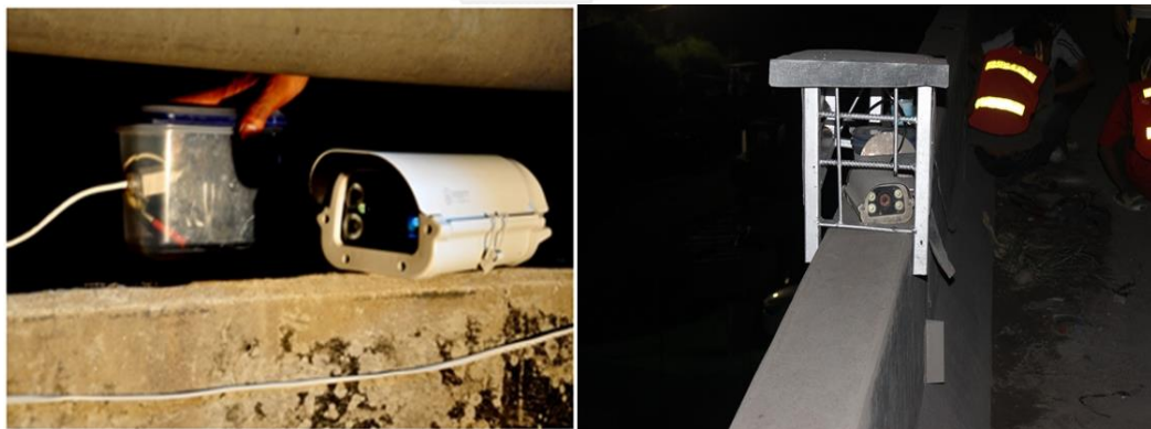
รูปที่ 3.16 กล้องวิดีโอบันทึกภาพที่ทำการติดตั้งบนสะพาน
