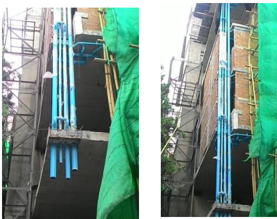
ภาพที่ 2.17 การเดินงานระบบสุขาภิบาลในช่องท่อ (Shaft) จะทำการเทพื้นเพื่อยึดแนวท่อบนบริเวณพื้นที่ชั้น 2 ไว้ แล้วจึงเดินท่อขึ้นไปในแต่ละชั้น
