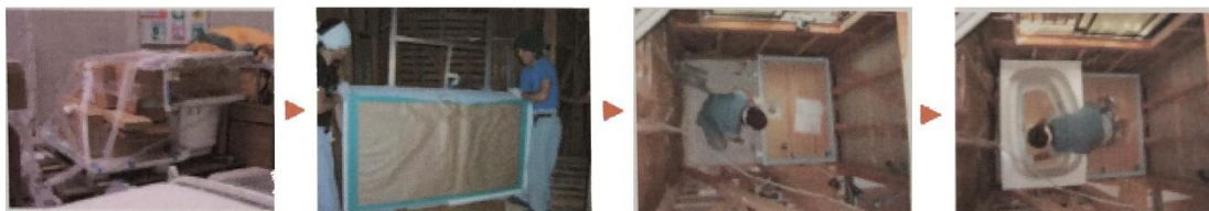
ภาพที่ 2.36 ขั้นตอนการขนส่งติดตั้งชิ้นส่วนระบบ SBM [27]
