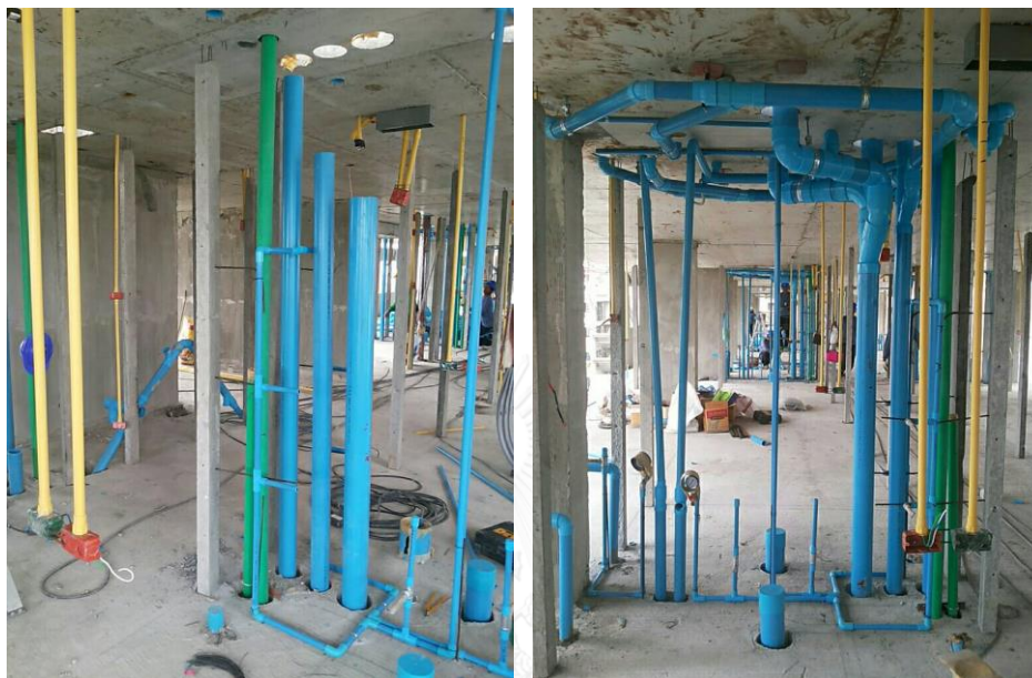
ภาพที่ 2.18 งานติดตั้งท่อระบบสุขาภิบาลของห้องชุดในอาคารชุดพักอาศัย จะทำการเดินตำแหน่งท่อนก่อน แล้วจึงก่อผนังตาม เพื่อไม่ต้องทำการเซาะผนังในภายหลัง [20]
