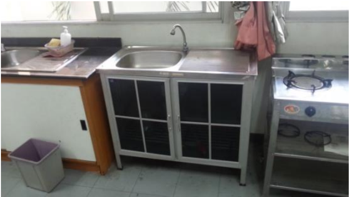
ภาพที่ 22 อ่างล้างจานภายในห้องครัวจำลอง
