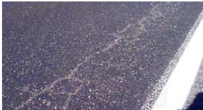
ภาพที่ 2.6 ลักษณะรอยแตกร้าวเนื่องจากความล้าบนผิวถนน (Fatigue Crack)
