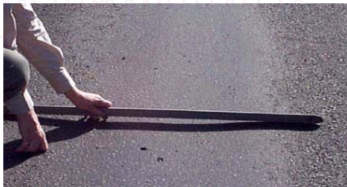
ภาพที่ 2.7 ลักษณะรอยร่องล้อบนพื้นถนน (Rutting)
