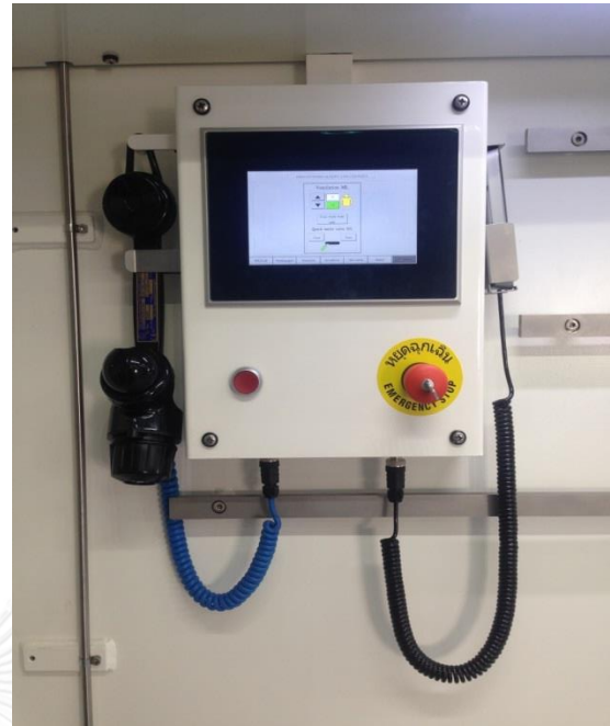
ภาพที่ 10 ระบบติดต่อสื่อสาร
