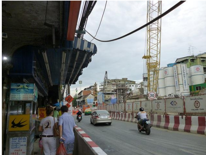
ภาพที่ 5 โครงการก่อสร้างรถไฟฟ้าใต้ดินบริเวณชุมชนเจริญไชย ถนนเจริญกรุง
