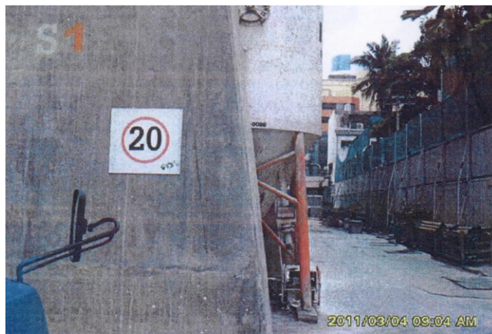
ภาพที่ 4 แสดงการจำกัดความเร็วของยานพาหนะ ที่มา : รายงานประจำเดือนมีนาคม 2011 โครงการ A
