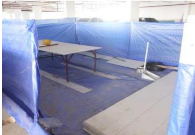
ภาพที่ 32 แสดงการปิดกั้นพื้นที่ที่ทำให้เกิดฝุ่น ที่มา : IAQ report โครงการ B
