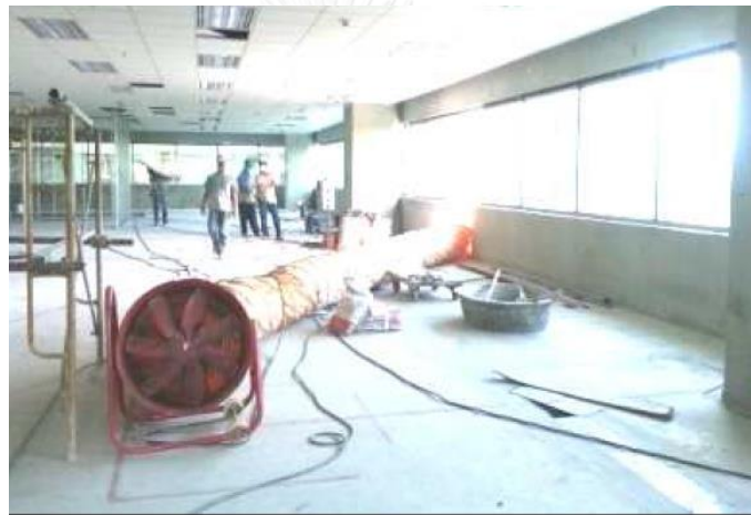
ภาพที่ 33 แสดงการใช้พัดลมอัดอากาศ ที่มา : IAQ report โครงการ B
