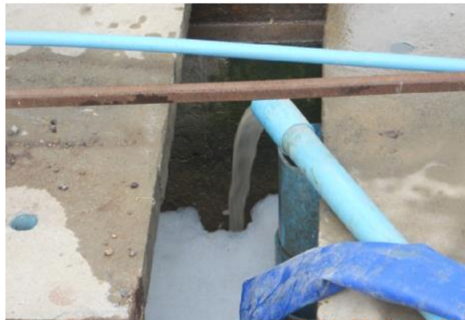
ภาพที่ 25 แสดงการตรวจสอบน้ำที่จากพื้นที่ก่อสร้างไหลลงสู่บ่อตักตะกอน ที่มา : รายงานประจำเดือนพฤศจิกายน 2012 โครงการ F
