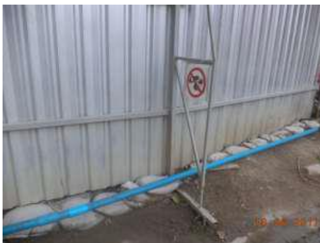
ภาพที่ 8 แสดงการใช้ถุงทรายเพื่อป้องกันตะกอนดินไหลออกจากพื้นที่โครงการ ที่มา : รายงานประจำเดือนมิถุนายน 2012 โครงการ B
