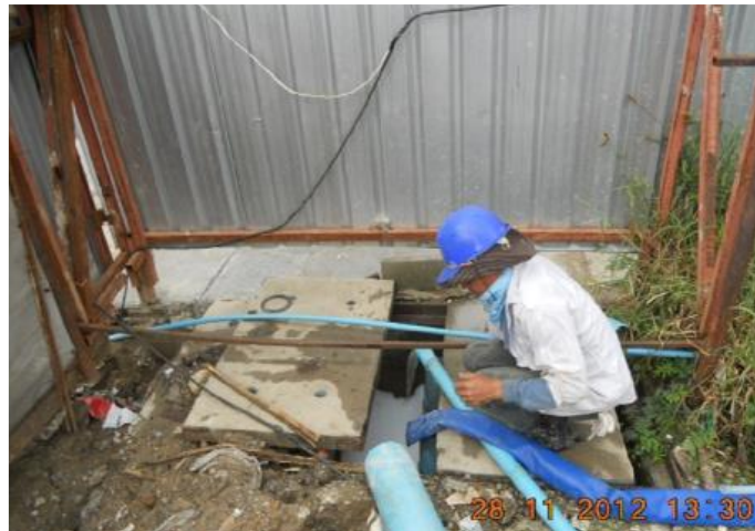
ภาพที่ 24 แสดงรูปภาพการกำจัดตะกอนเมื่อสูงเกินครึ่งบ่อ ที่มา : รายงานประจำเดือนพฤศจิกายน 2012 โครงการ F
