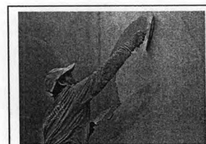
รูปภาพ 5.41 แสดงลักษณะการฉาบแต่ผิวคอนกรีตและแต่ผิวรอยต่อ
