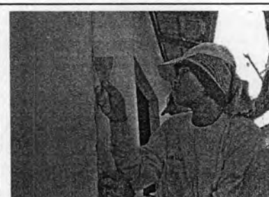
รูปภาพ 5.22 แสดงการแกะปูนแต่งผิวบริเวณส่วนที่จะต้องอุดด้วย Polyurethane
